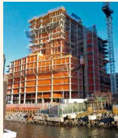
図3 ブルックリンもリバーフロントは建設ブーム 撮影/筆者
